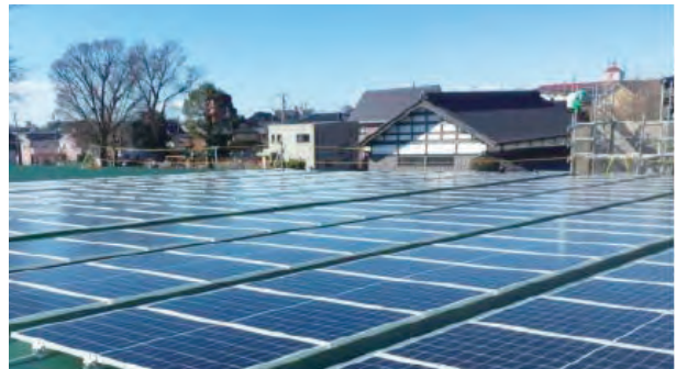
太陽光発電パネルを設置した店舗
